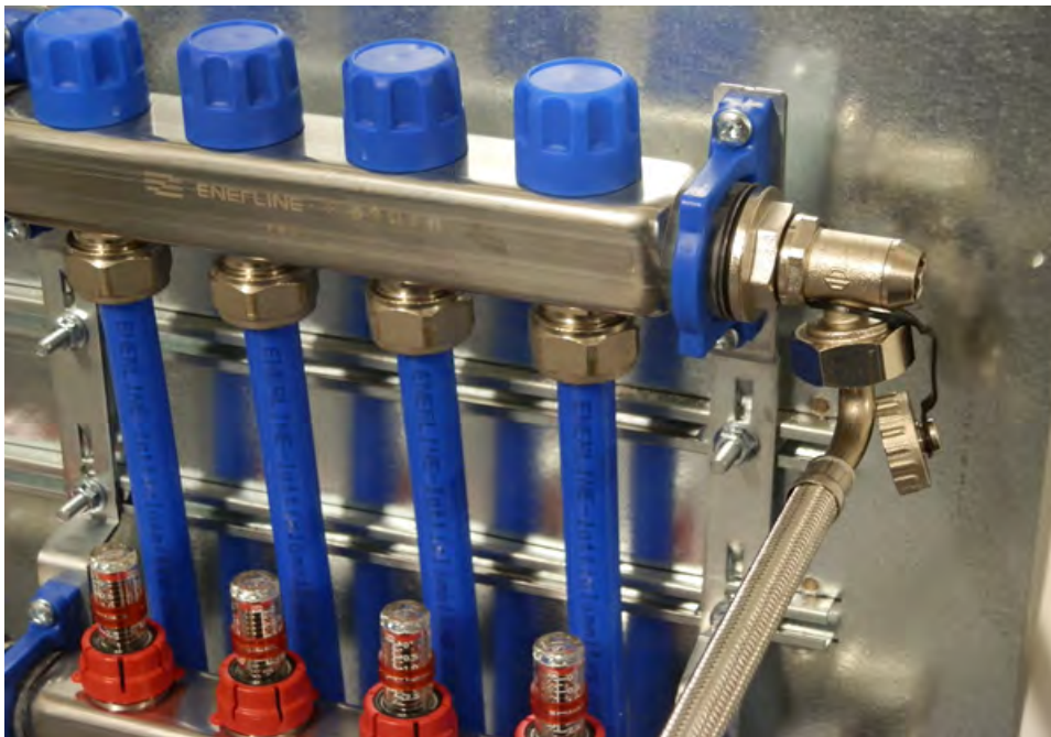
Bild 2. Avluftningsslang ansluten till avluftningsänden.
