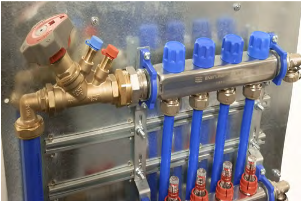
Bild 1. Avstängningsventilen är öppen på framledningssidan och stängd på retursidan.
