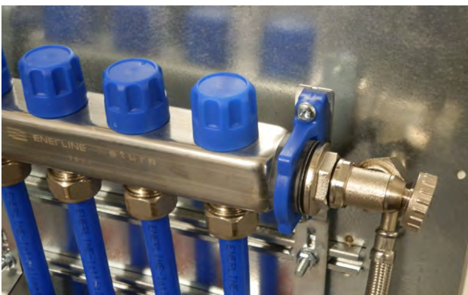
Bild 3. Öppning av avluftningsändens ventil.
