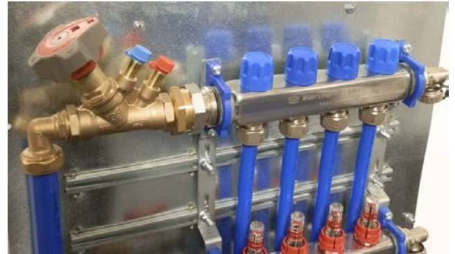
Menopuolen sulkuventtiili auki ja paluupuolen sulkuventtiili kiinni.
