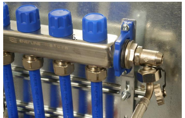
Ilmausletku kytketään ilmauspäättyyn.
