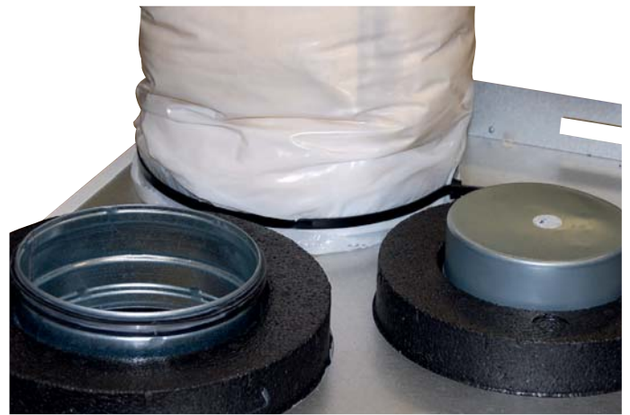
Valmiiksi asennettu kanava.
