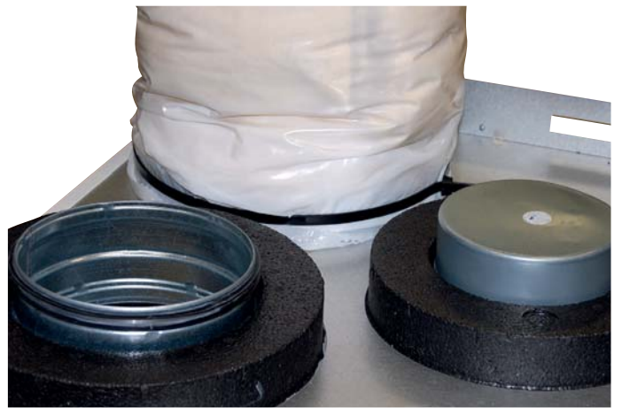
Valmiiksi asennettu kanava.
