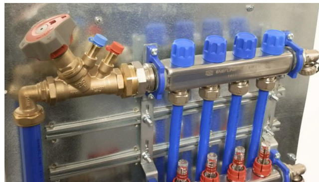
Menopuolen sulkuventtiili auki ja paluupuolen sulkuventtiili kiinni.
